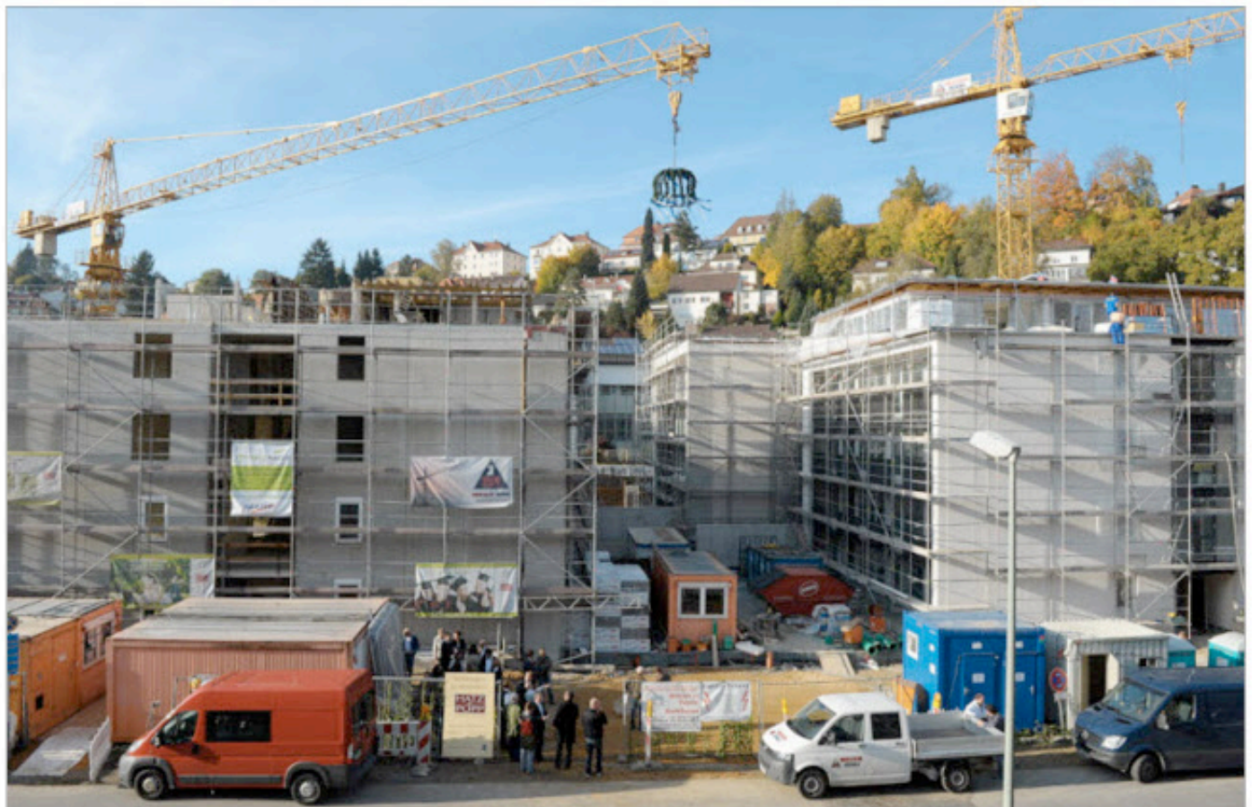
Die Krone (hoch oben am Kran hängend) aufgesetzt haben gestern Nachmittag die Investoren der Studenten-Wohnanlage
